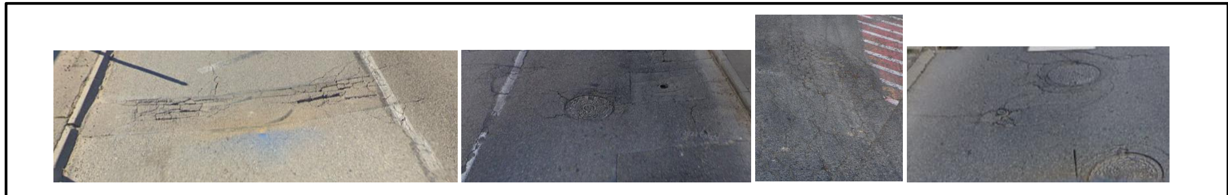
Illustration dégradation enrobé – rue Bessemer
